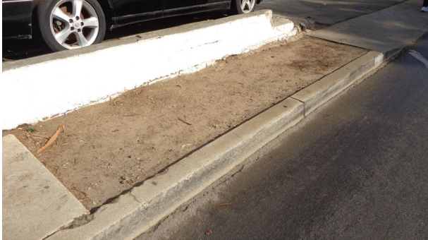
Before: 1205 El Segundo Blvd. missing sidewalk
